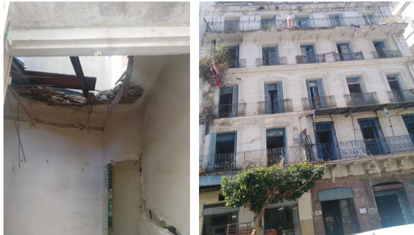
Figure 64 des immeubles avec une grande valeur architecturale et un état de structure très dégradé
