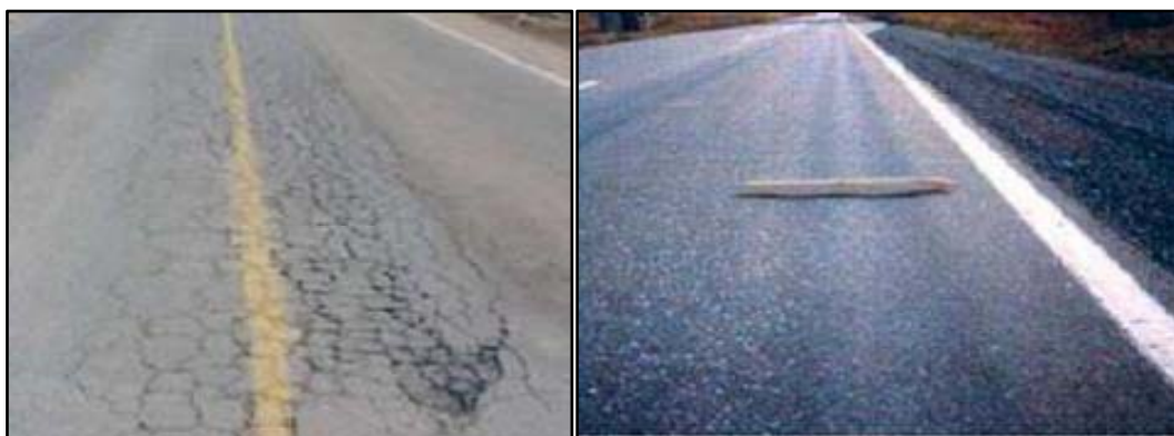
1-faïences 2-ornières Longitudinales
