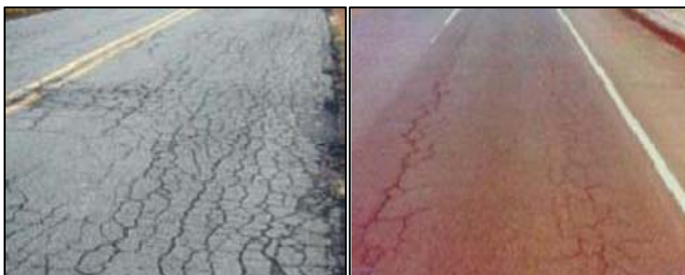
3-fissures en carrelage 4-fissures longitudinales
