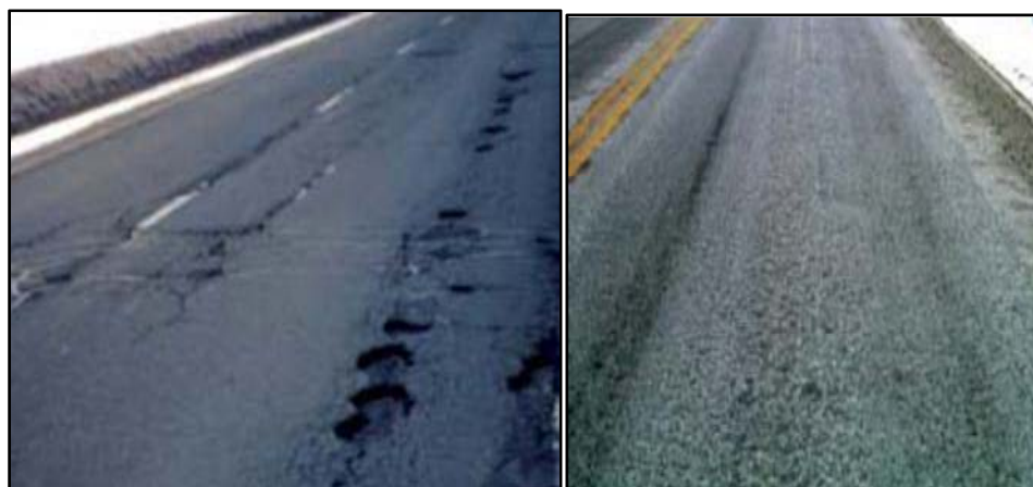
5-desenrobages et arrachements de revêtement 6-perte de revêtement
