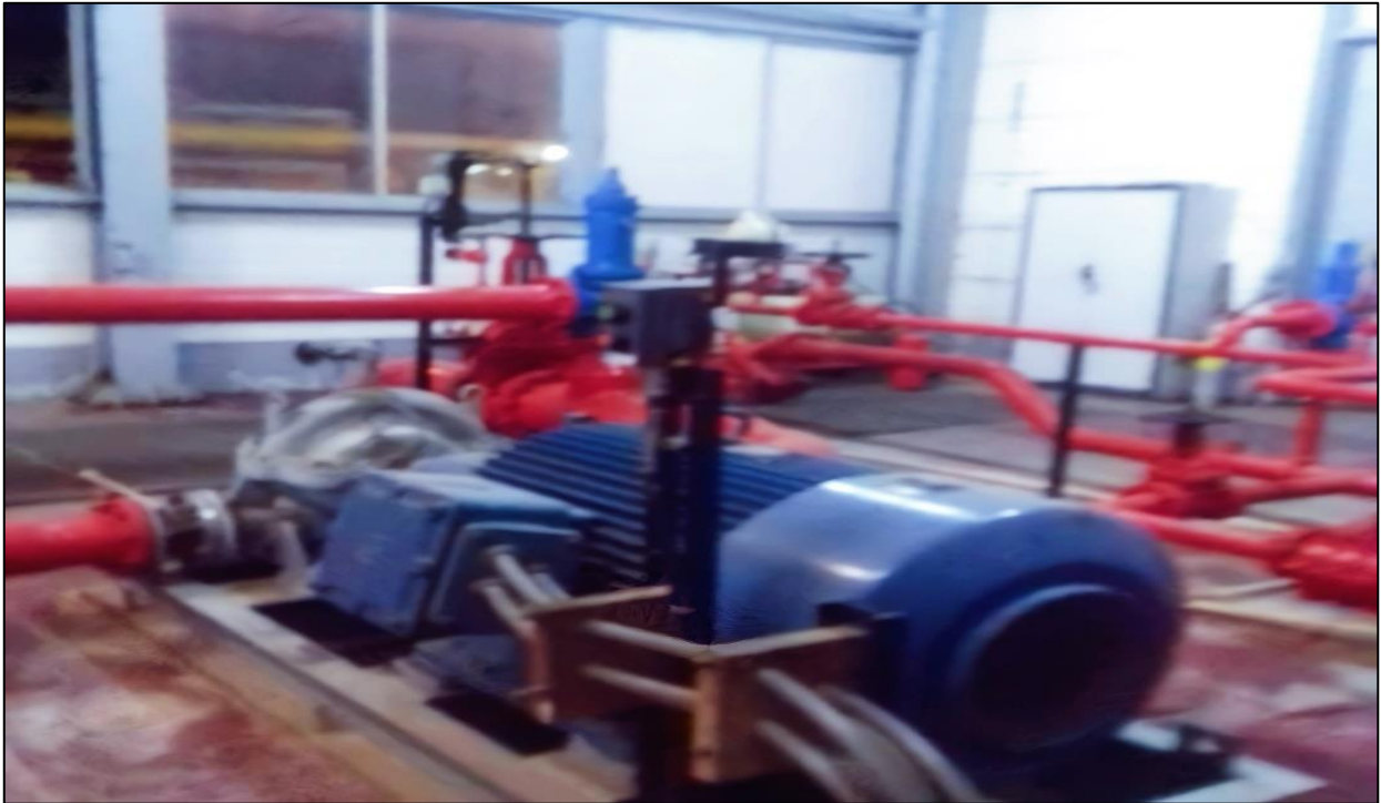
Figure II-16 : Pompes à eau d'extinction P320 (électrique)
