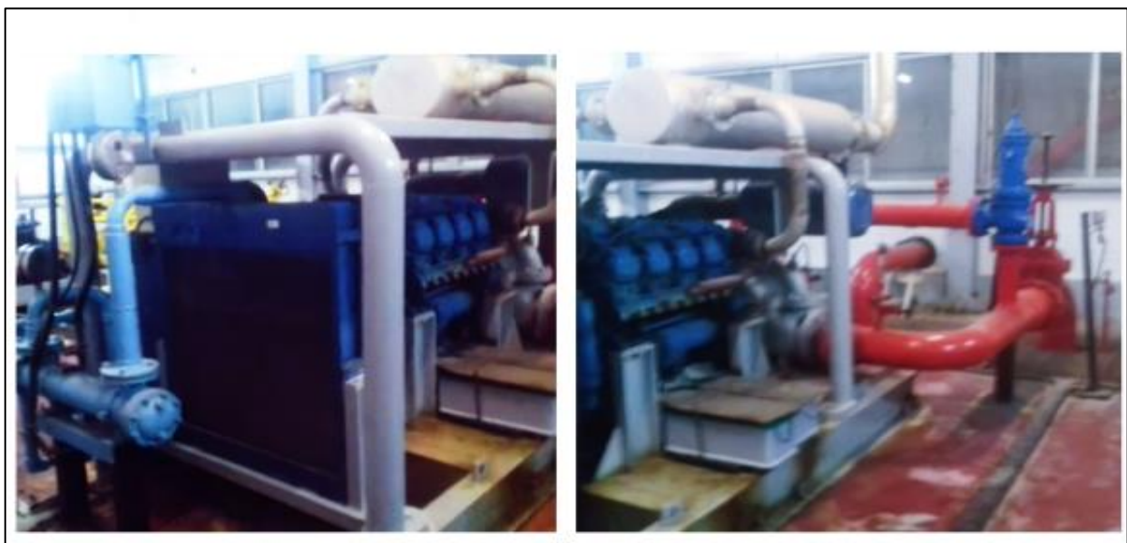
Figure II-4 : Pompes à eau d'extinction P310 (à moteur diesel)
