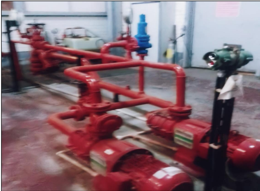
Figure II-3 : Pompes électriques pour l'alimentation en eau
