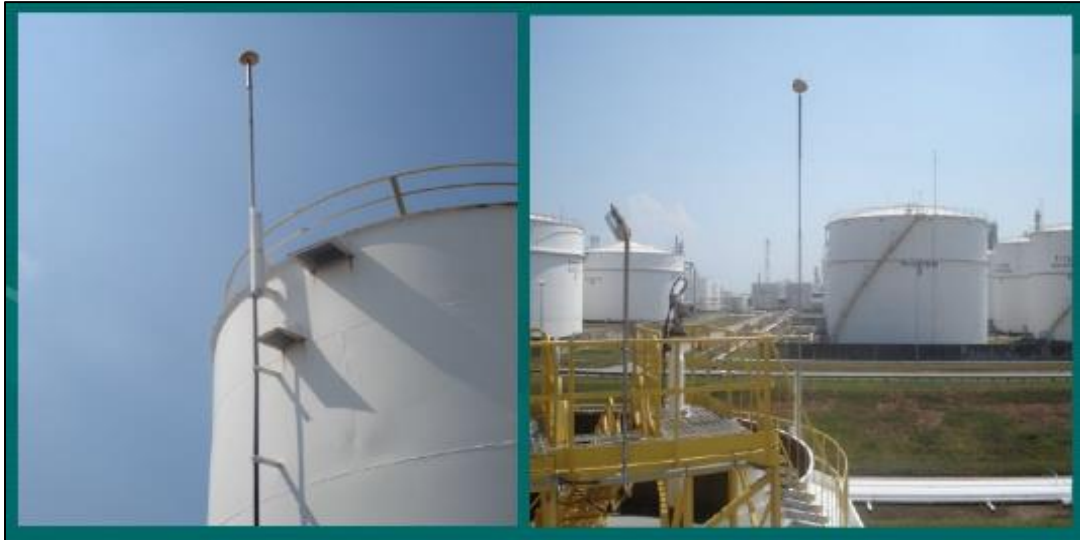
Figure II-11 : Vue extérieure des poteaux parafoudres [21]
