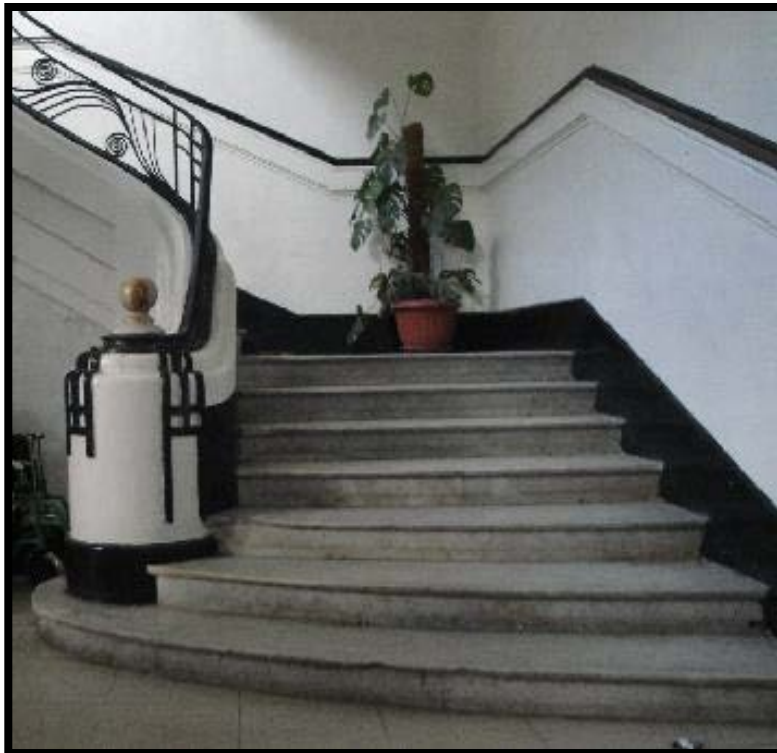
Figure77 : photo sur l'escaliers intérieur de l'hôtel de ville de Mostaganem en bon états
