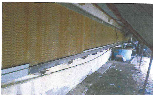
Figure 09 : la loge qui abrite l'humidificateur installée le long du bâtiment[Personnelle 2012].
