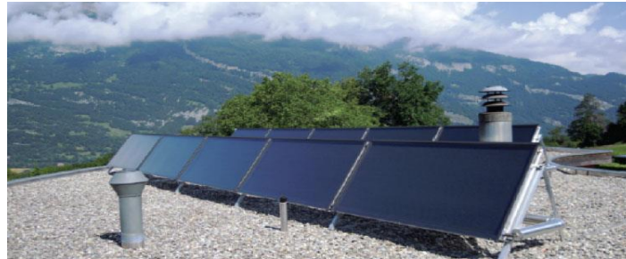
Figure 12 : Les capteurs solaires thermiques
