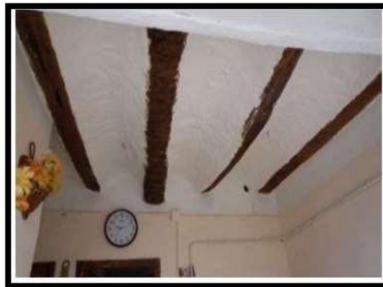
Figure II.82 : Plancher en troncs de palmiers et voûtains dans une habitation du ksar source : Types_de_plancher_dans_les_constructions_traditionnelles_dans_la_vallée_du_M'zab PDF
