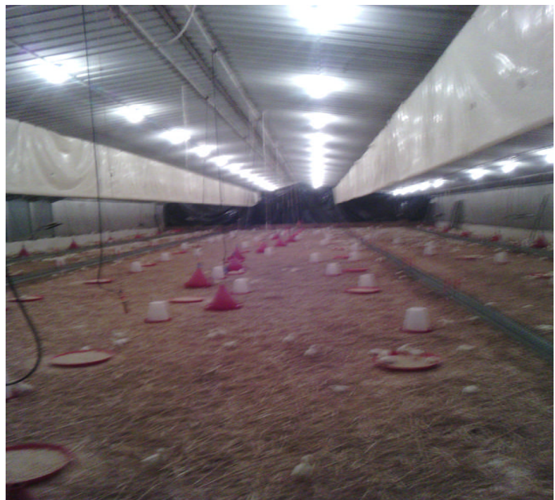
Figure 10 : L'éclairage de bâtiment
