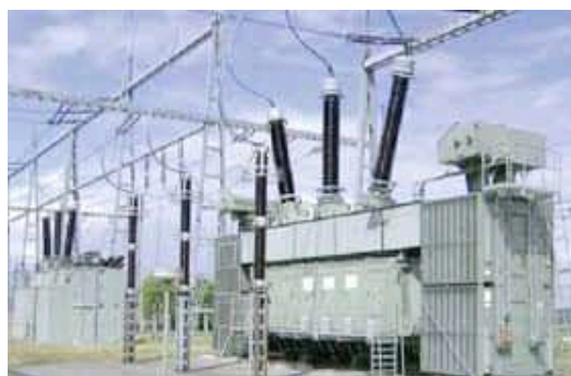
FIGURE 2.1 – Station de distribution électrique
