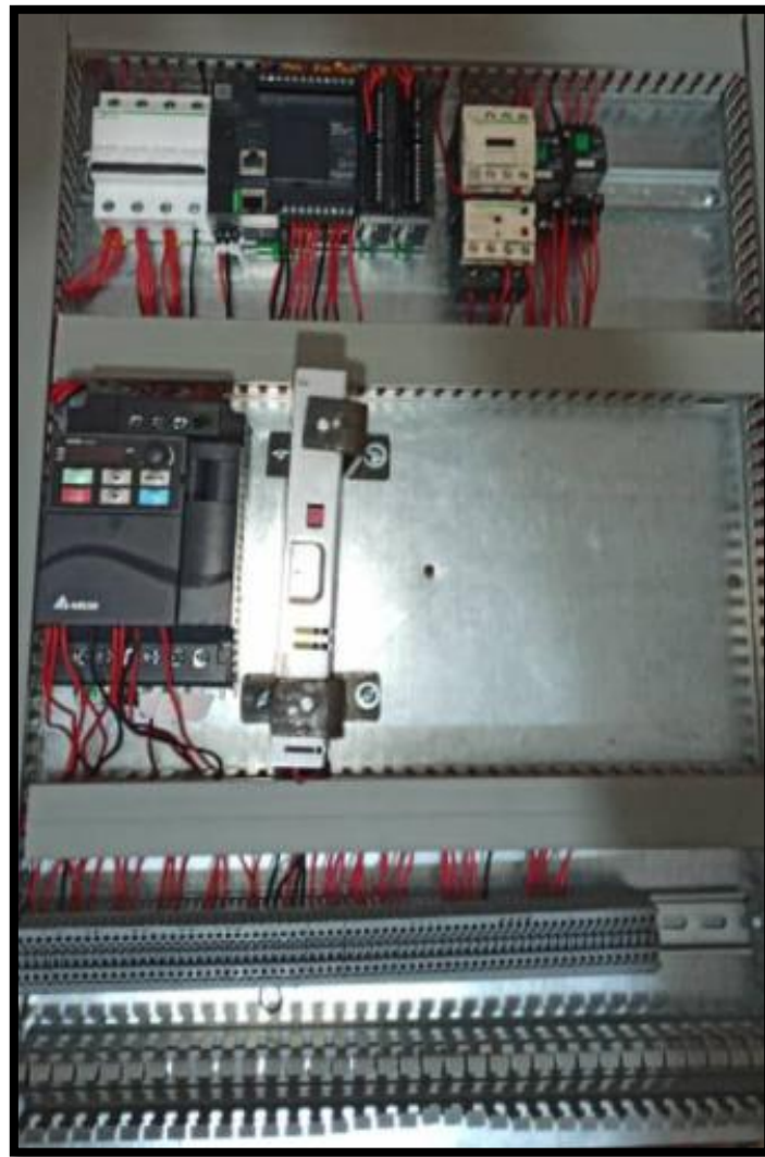
Figure 4.8: armoire électrique avec ses composants câblés
