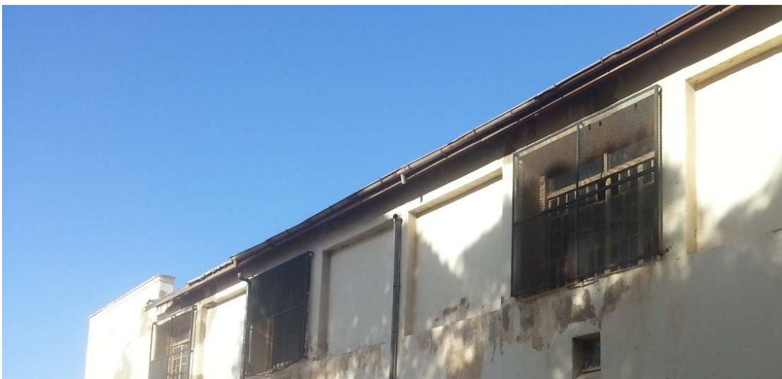
photo 16 débordement du toit sur la partie centrale et emplacement des évacuations des eaux de pluie
