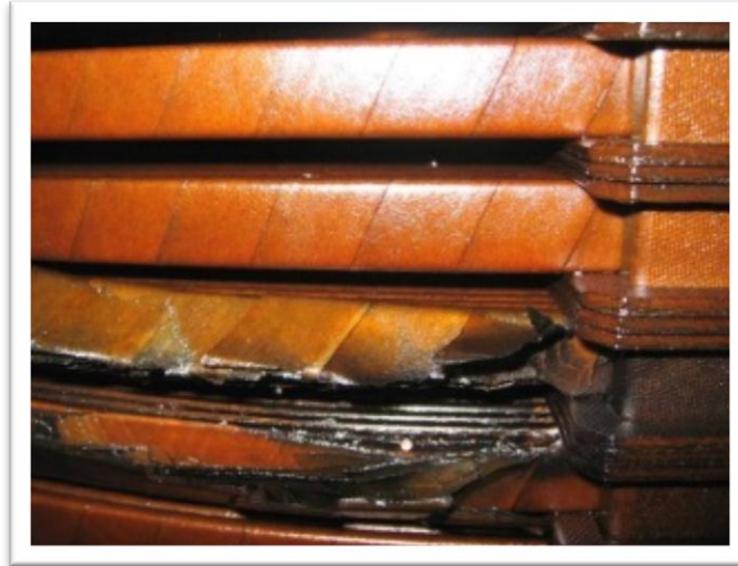
Figure 2.4 : amorage entre les spires
