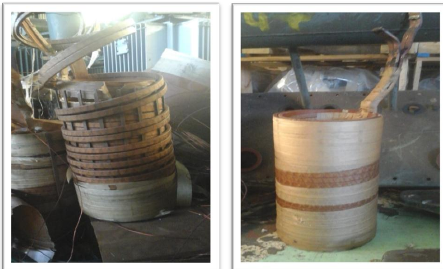
Figure 3.29 : déformation géométrique des l'enroulement
