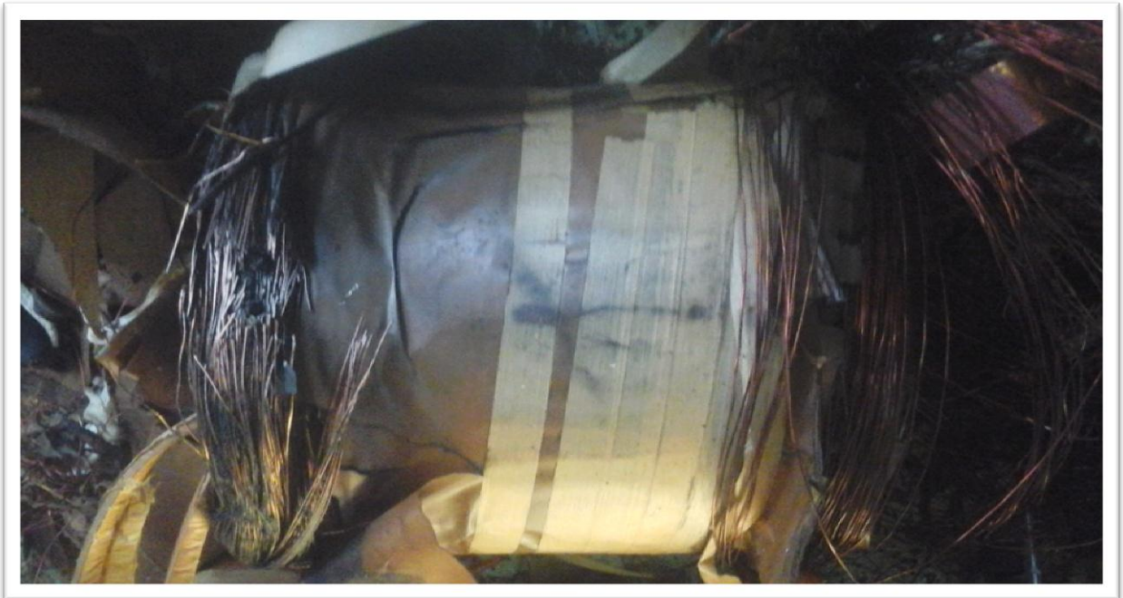
Figure 2.1 : court-circuit entre les spires HT
