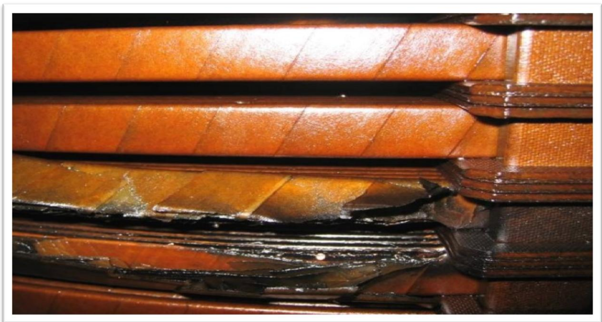
Figure 3.13 : court-circuit entre les spires des enroulements
