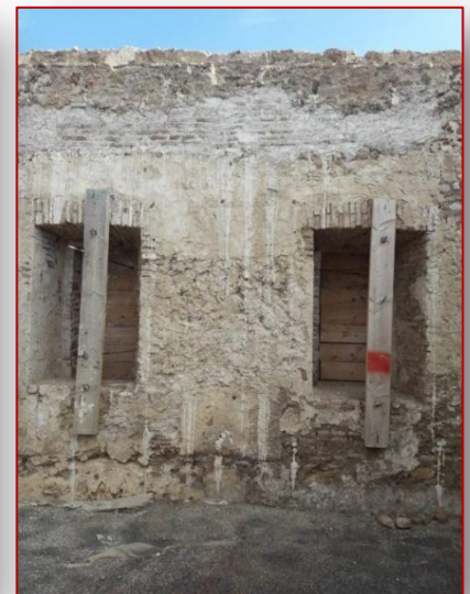
Figure 128: état de la brique de la salle de l'étage
