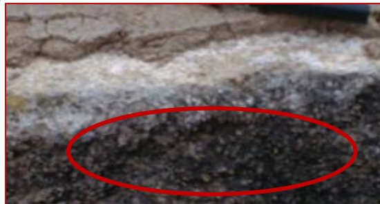
Figure 59: c Détails d'efflorescence
