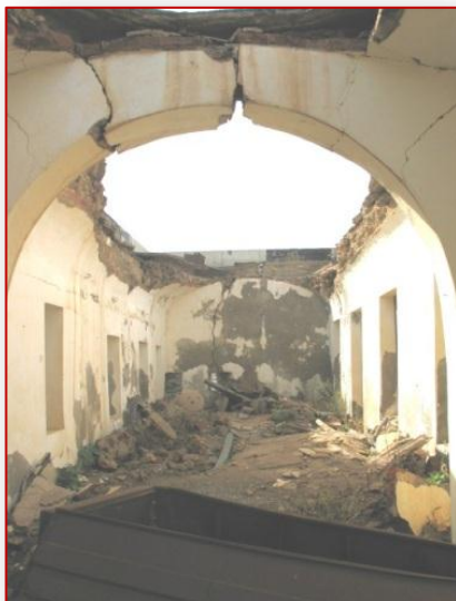
Figure 126: Effondrement de la voûte qui couvrait la salle de l'étage
