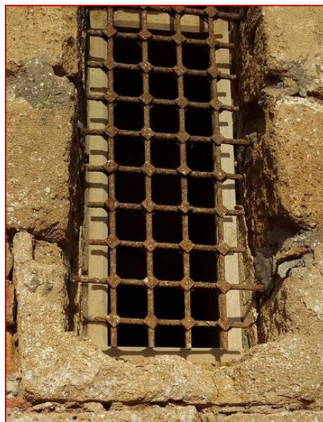
Figure 130: Apparition rouille au niveau de grillage de la fenêtre
