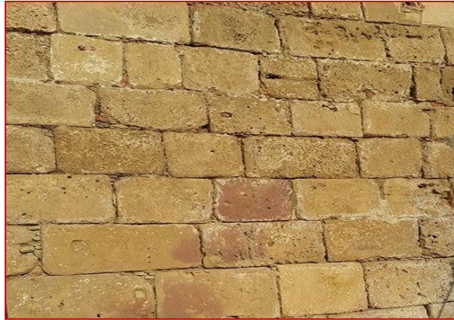
Figure 129: Dégradation du mortier surtout au niveau de la façade nord
