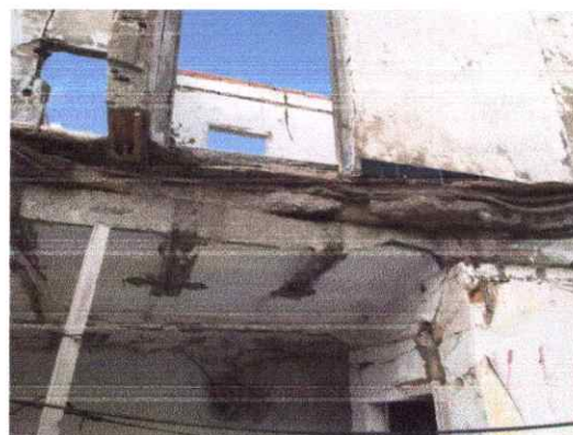
Fig. 3.15 fissure laissant apparaître les différentes couches du plancher.
