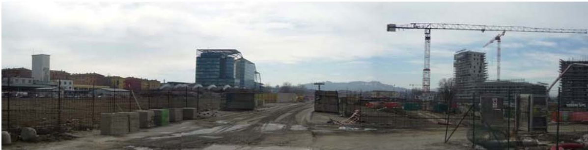
Image panoramique du site en construction (mai 2012) : à gauche la tour d'entrée au marché ; au centre le siège des bureaux municipaux et à droite les premiers bâtiments résidentiels en construction
