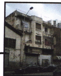
Figure 3.48 : Habitat en mauvaise état
