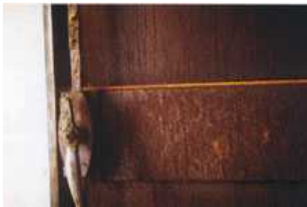
Image 1 : Corrosion d'une porte en acier
