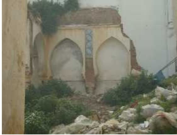
Image1 :L'état de dégradation de la casbah et l'apparition du béton armé un matériau non familiarisé à la Casbah
