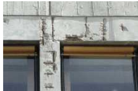
Image 2 : Corrosion de béton
