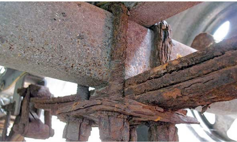
FIGURE 15 : EXEMPLE DE CORROSION MARINE
