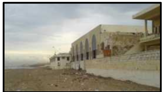
Figure 32: l'humidité peut causer la corrosion des façades
