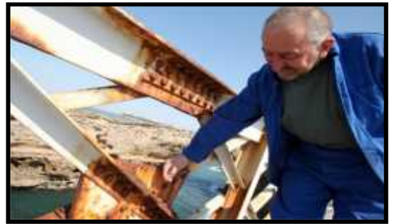
Figure 31: l'humidité peut causer des dommages sur la structure
