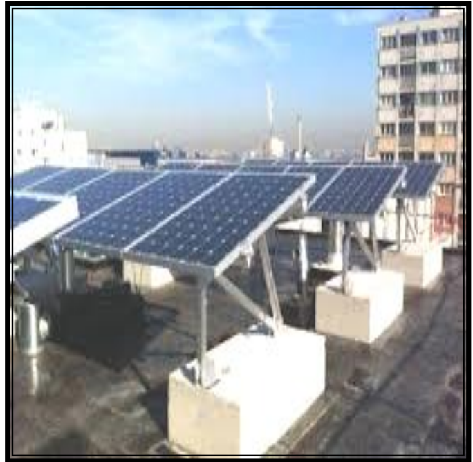
Image 31 : Les panneaux solaires.
