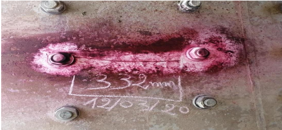
Figure 1.14: Apparition de la fissure sur la virole
