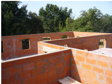
Fig. 25. Utilisation de la brique creuses locale, (Source plan remis par le propriétaire).
