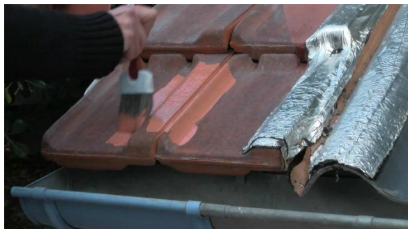
Fig. 28. TRAITEMENT DE PROBLEME D'ETANCHITE, (//www.eco2travaux.fr/index.php/artisan38).
