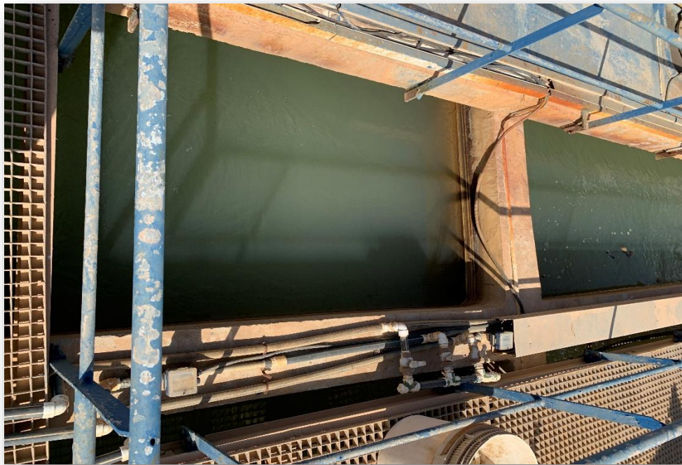
Figure 3.10 : injection des réactifs (bassin répartiteur)
