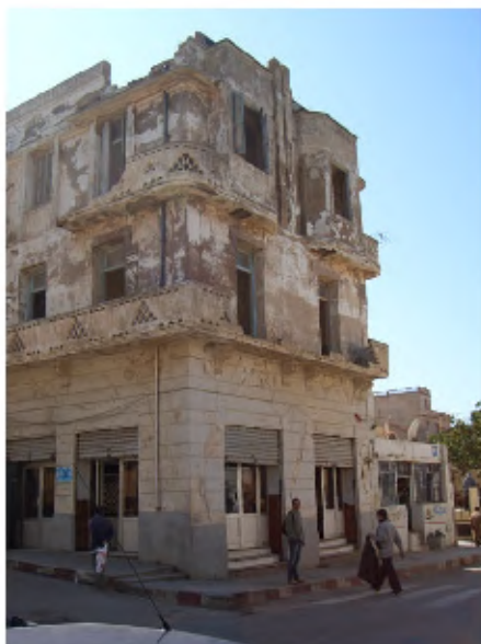
a : Dégradation et abandon des immeubles d'habitats dans le centre ville.
