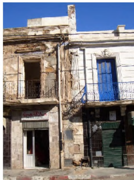
b : dégradation sur le front urbain de l'axe principal du centre ville
