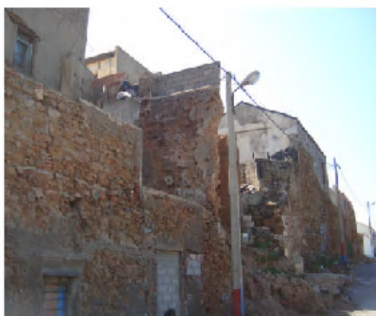
c : Dégradation de la façade maritime nord/est du centre ville
