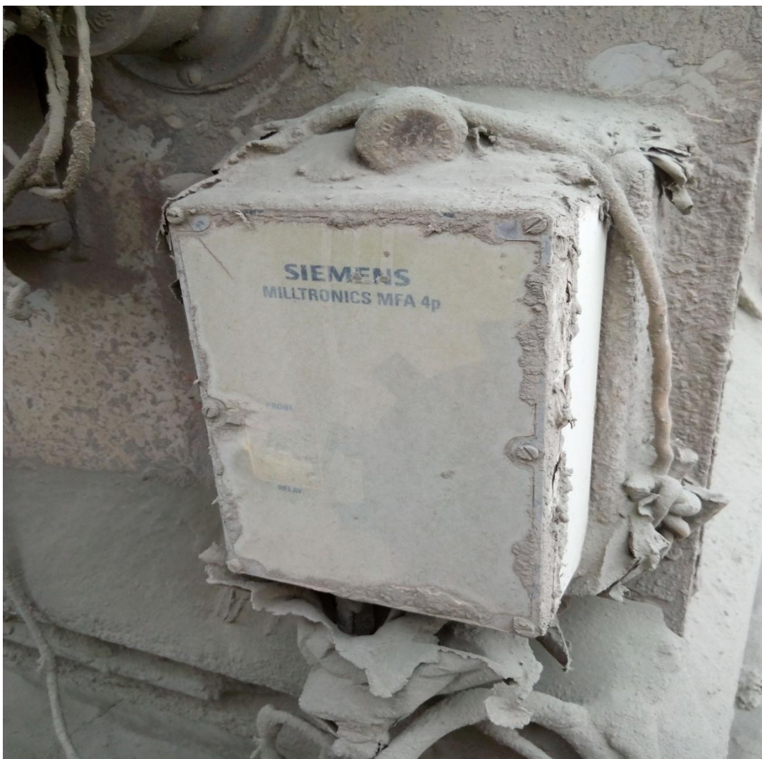
Figure32 :Alimentation de détecteur Godet élévateur T15
