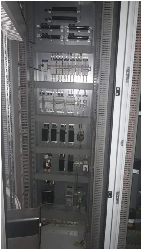
Figure 1.21. L'armoire de protection.
