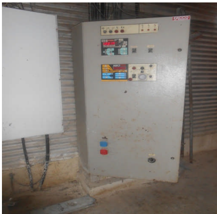
Armoire de commande
