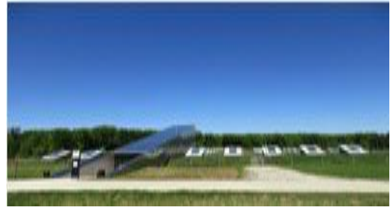
Figure 78 : Capteur solaire thermique et photovoltaïque, sur la toiture végétale de la Gare TGV de Besançon. 3
