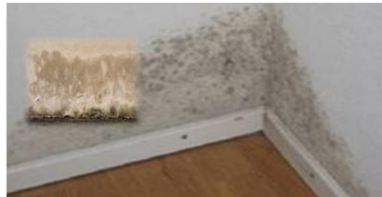
Figure 79 : mur avec phénomène d'humidité
