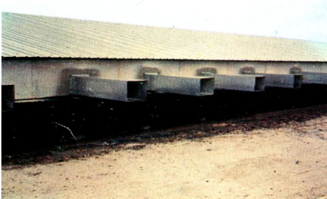
Figure 12: Orifice à ventilation dans un poulailler à ventilation mécanique.
