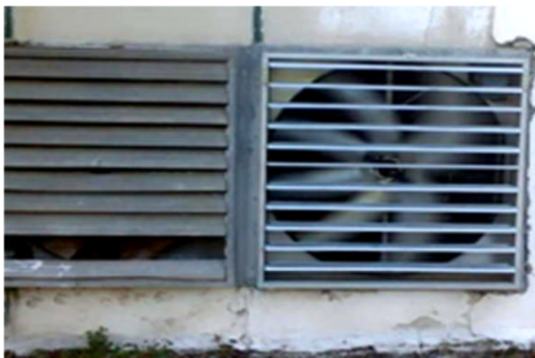
Figure 18: Extracteur principale du bâtiment.
