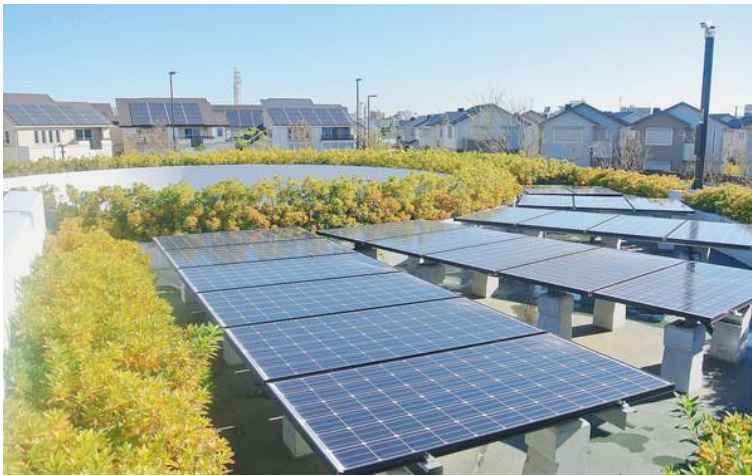
Figure 110 : photo des panneaux photovoltaïques dans les passages couverts
