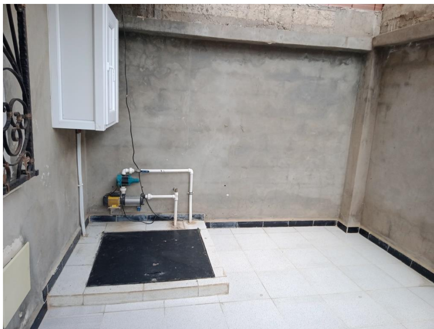
Photo 13 : L'installation d'une bache d'eau avec pompe (suppresseur) d'un habitant du quartier (Source : auteur)
