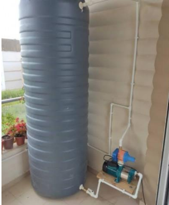
Photo 5 : L'installation d'un dispositif de stockage dans le rez-de-chaussée du bâtiment résidentiel investigué
