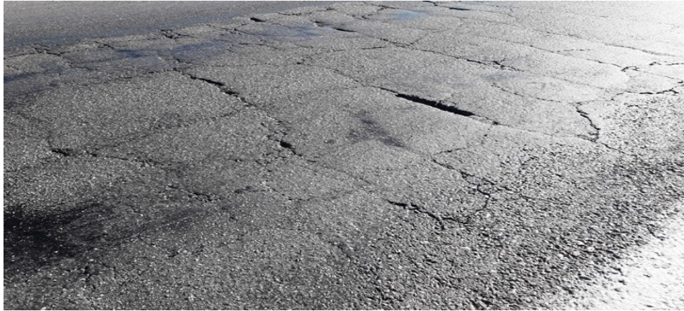
Figure III.5- Fissuration par fatigue d'une chaussée bitumineuse (RN1, Pk 627)
