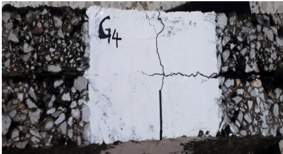
Fig. IV.27- Photo prise montrant l'évolution de la fissuration de la géogridde G4 (50°C).
