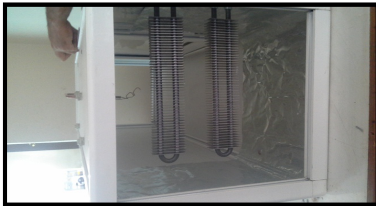
Figure 4.24 : photos de système de chauffage
