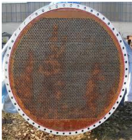
Figure I.21 : La corrosion dans un échangeur industriel
