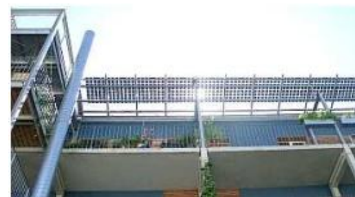
Figure19: vue sur le capteur thermique et le PV du quartier Vauban
