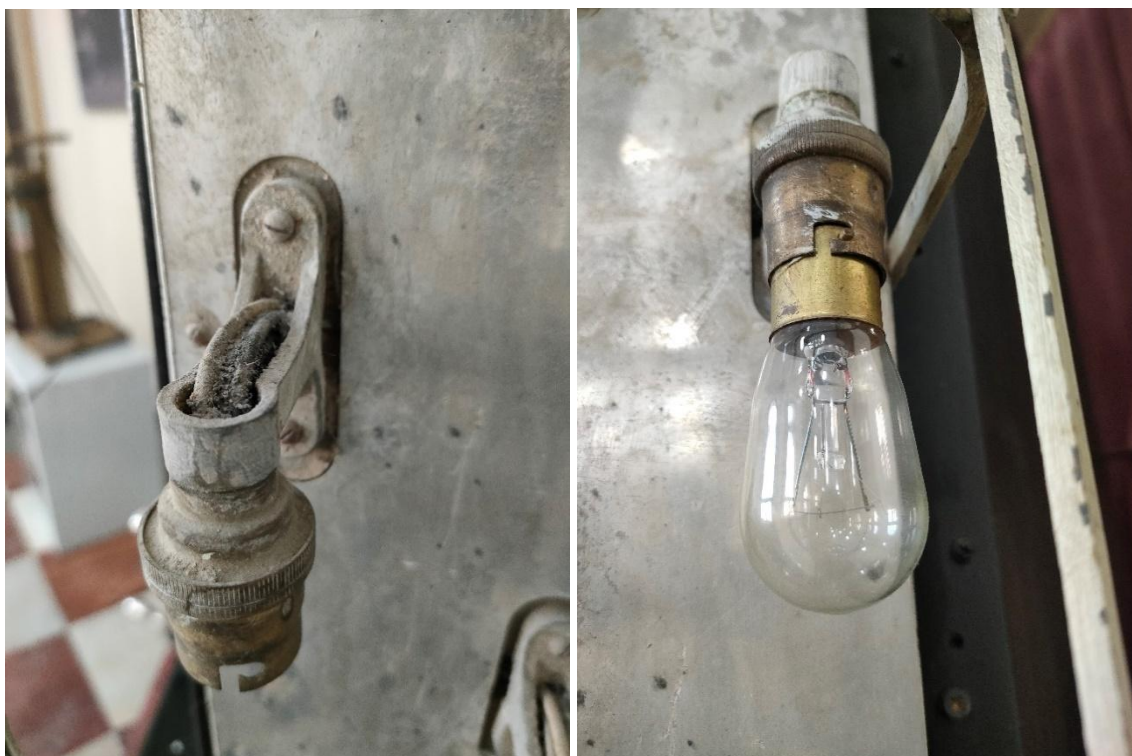
Figure III-1.14 (à gauche) : Les anciennes tuyauteries de gaz reconverties en circuits électriques des gorges lumineuses de la salle de spectacle du théâtre de Constantine.
