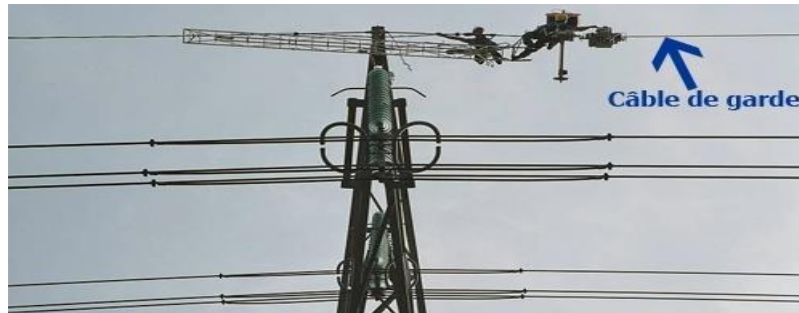
Figure I-7 : câbles de garde.
