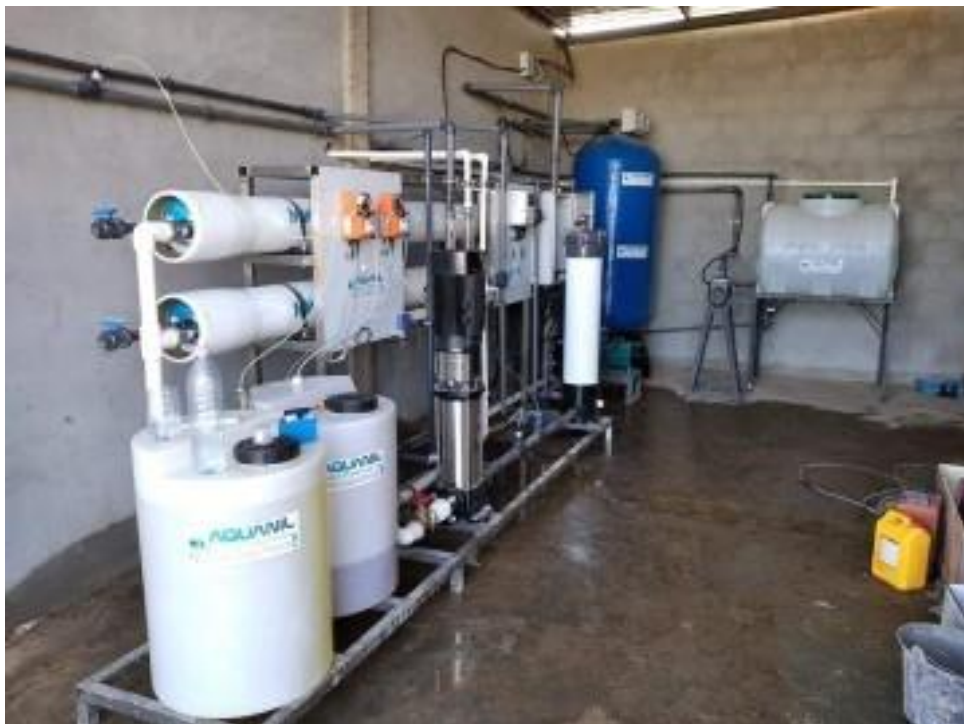
Figure.V.05 : une station par osmose inverse aquanil
