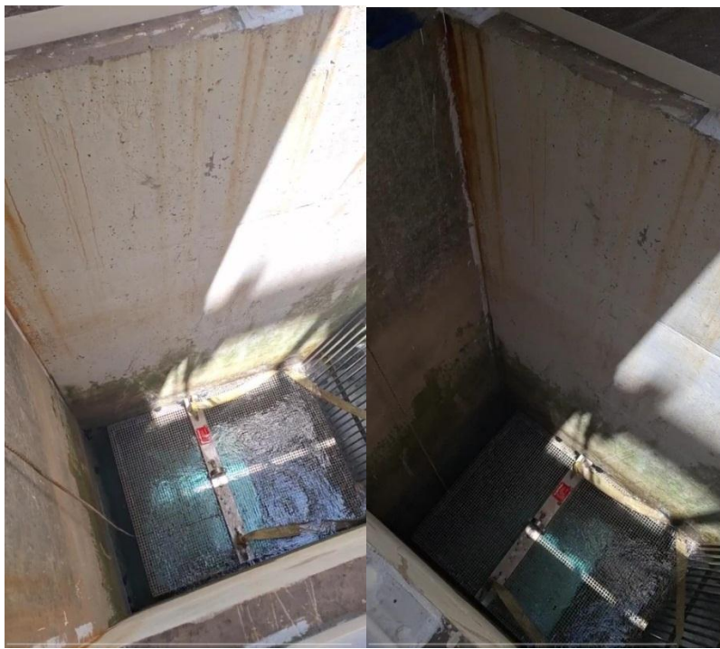
Figure .III.03: Le dé-grilleurs de la station de pompage
