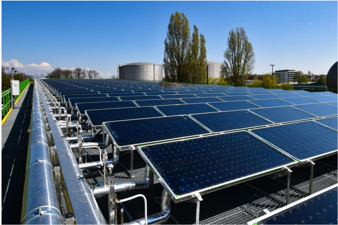
Figure IV.02 : Une station solaire-thermique
