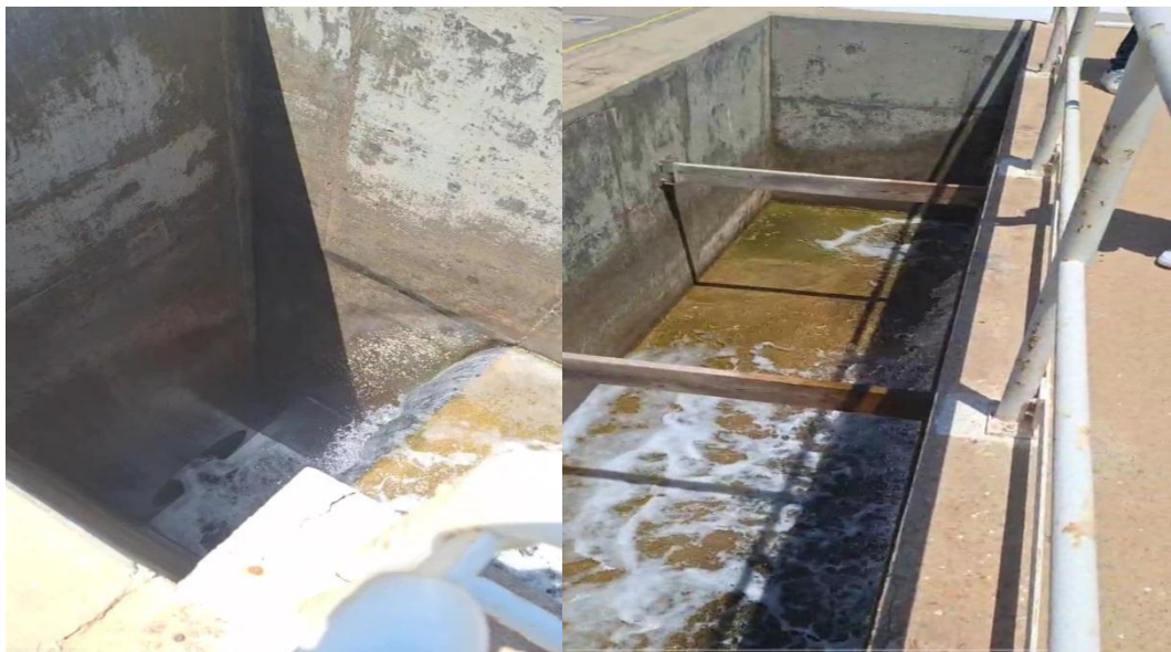
Figure .III.04: Le dé-grilleurs de la station de pompage Filtration mécanique sur grilles et tamis
