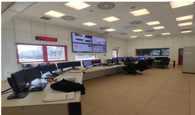
Figure 3.1 : La salle de commande
