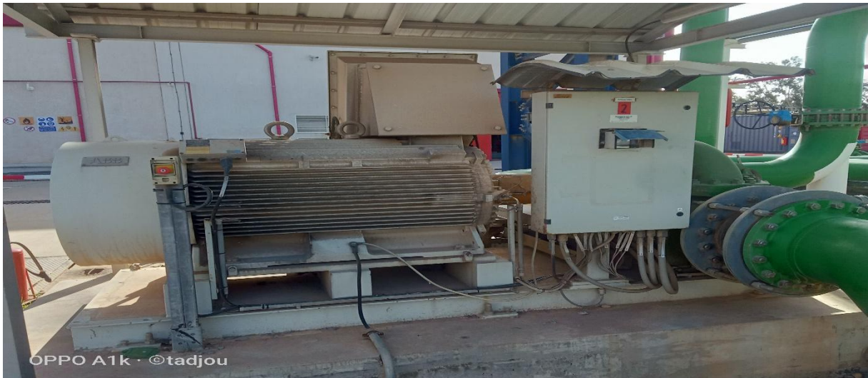
Figure 2.10 : La pompe à eau
