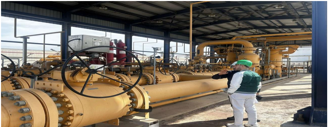
Figure. II .5 : Le poste de gaz
