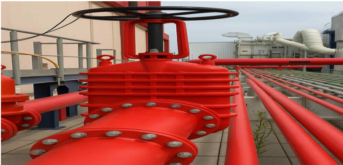
Figure. IV.4 : Vanne de l'eau entier incendie après et avant la maintenance
