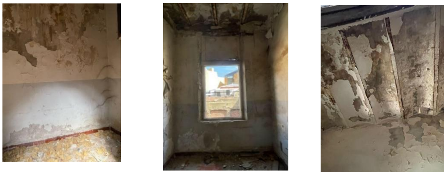
Fig :69,70,71 : décollement de la peinture source : auteur
