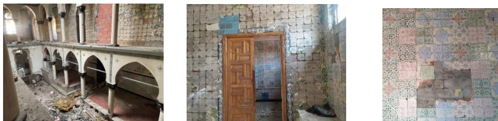
Fig :72,73,74: décollement de la céramique source : auteur
