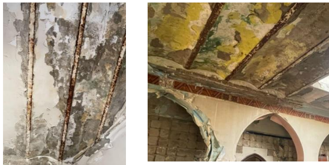
Fig :62 63 : corrosion des métaux source : auteur
