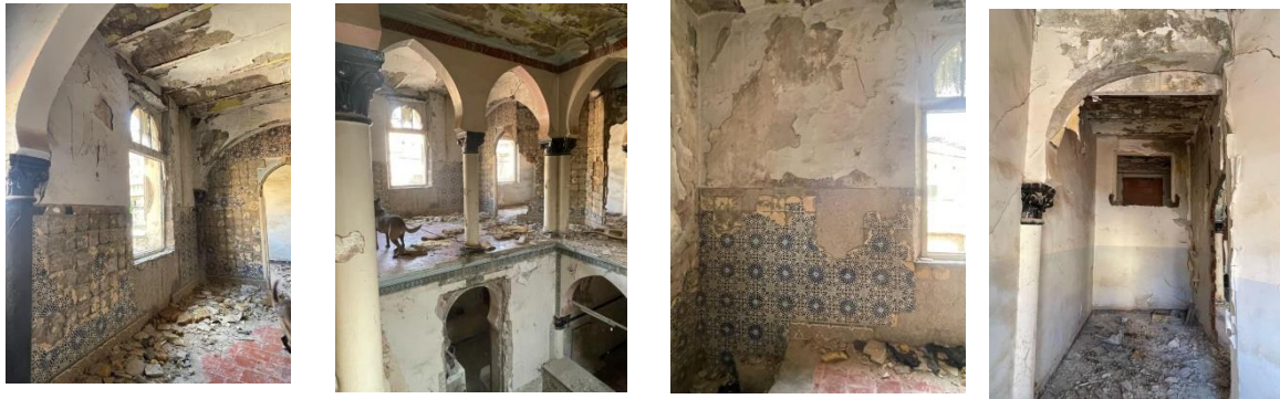
Fig :61,62 : dégradation des murs source : auteur
