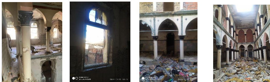
Fig :66,67,68 : dégradation due à l'action humaine source : auteur
