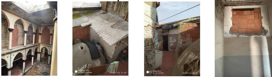
Fig :64,65,66 : utilisation des matériaux incompatibles source : auteur
