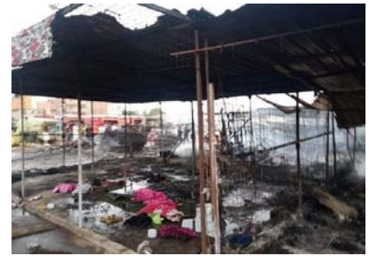
Figure 84 : dégâts d'un incendie en 2016
