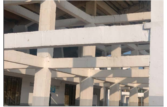
Figure 82 : photo représente les fissures sur les gradins
