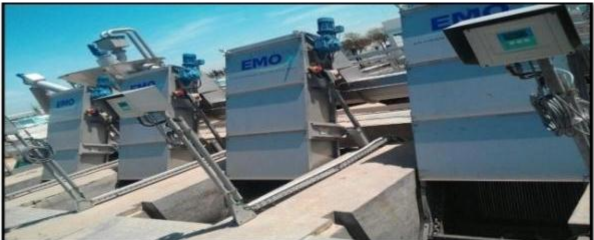
Figure 10 : Dégrilleur automatique fin (Originale, 2025).
