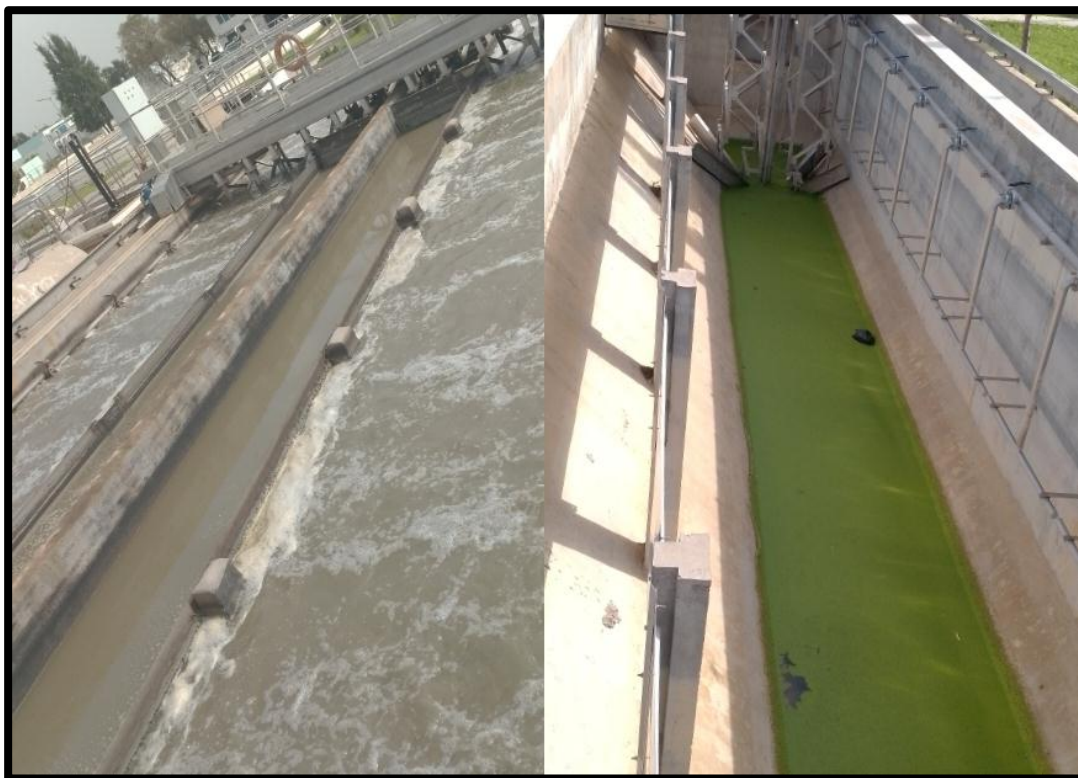
Figure 12: Ligne de dessableur –déshuileur (Originale, 2025).
