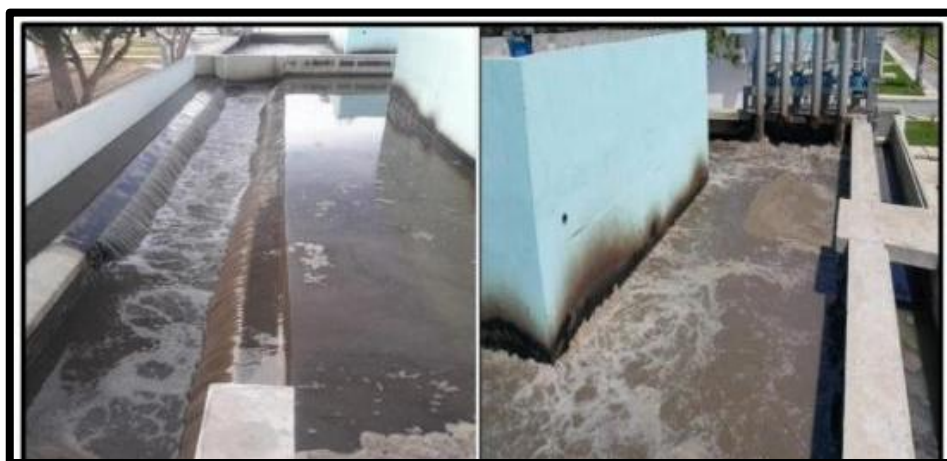
Figure 16 : Bassin d’aération de la STEP de Beni Mered (Originale, 2025).
