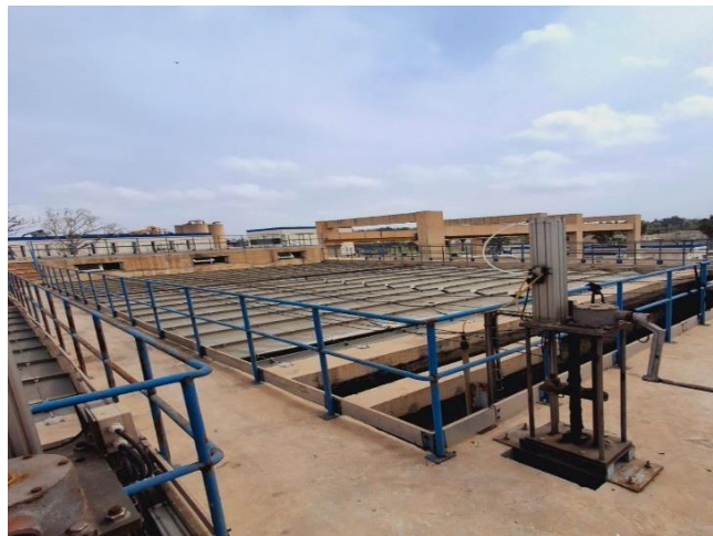
Figure 10 : Filtre à sable (photo originale)
