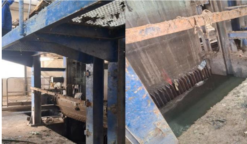
Figure 4 : Dégrilleur (photo prise sur terrain Mars 2025).
