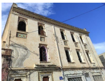
Figure 176: Bâti en mauvais état Source : Auteurs
