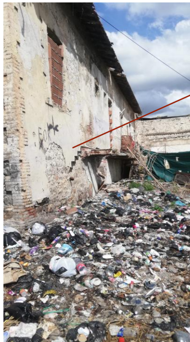
Figure 62: l'escalier de la partie Nord des annexes effondrés
