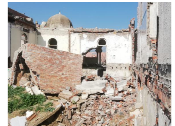
Figure 41: Toiture effondré. Source : Auteur, 2025.
