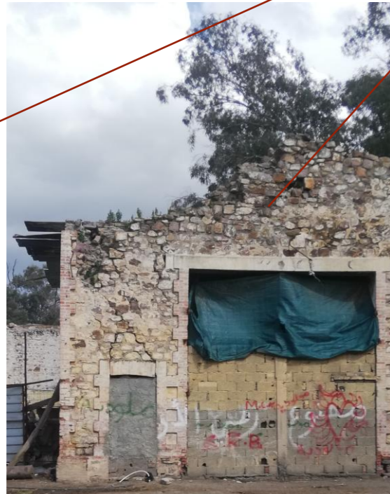
Figure 61: le mur de la partie sud des annexes dégradé.
