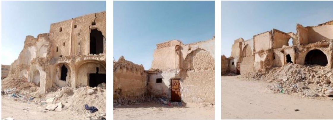
Figure 42 : des images montrant la dégradation actuelle de ksar et son effondrement important ; source : auteur
