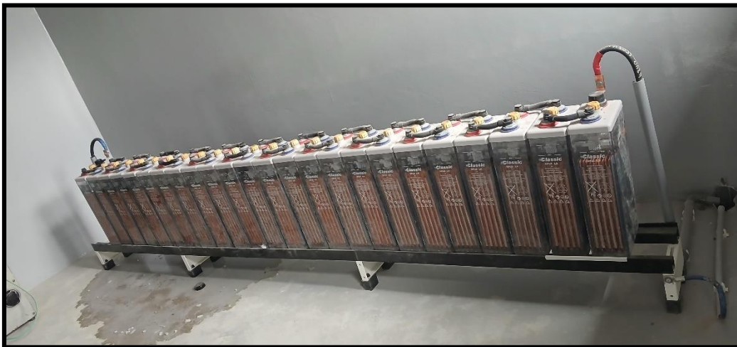
Figure 2.18: Batteries stationnaires de type Classic OPzS LA (48V)
