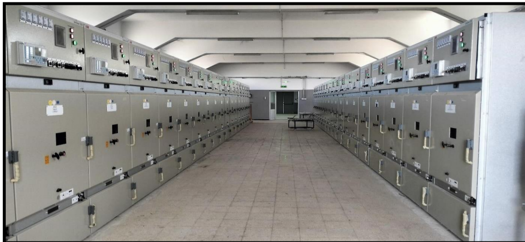
Figure 2.11 : Etage HTA 30kv :différents types de cellule d'un poste électrique
