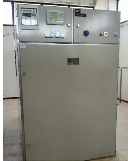
Cellule ALSTHOM 30kv
