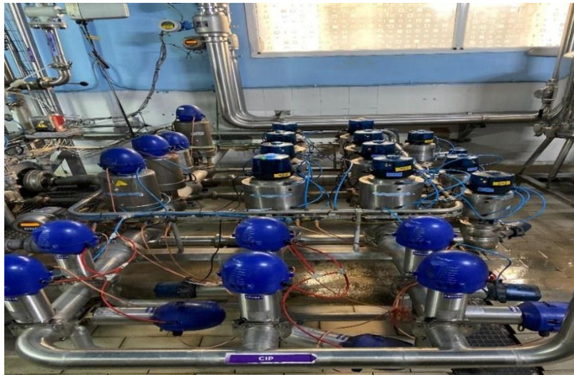
Figure 13 : SKID des vannes automatiques « photo originale »
