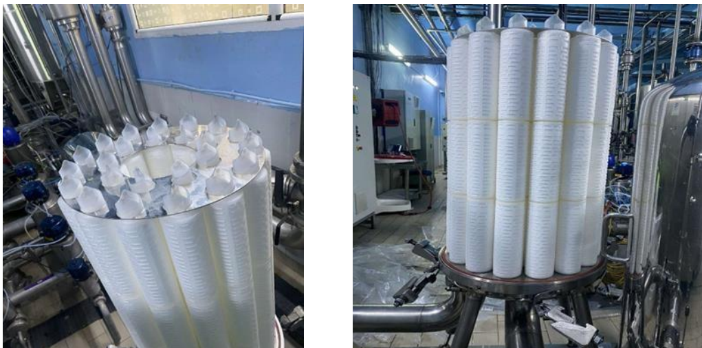
Figure 09 : Filtre à cartouche « photos originales »
