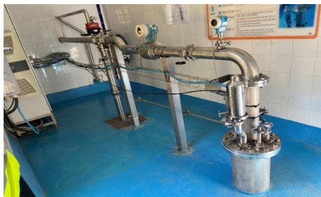
Figure 07 : Canalisation en inox « photo originale »
