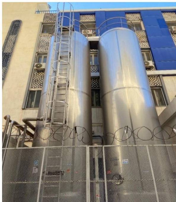
Figure 11 : Cuve de stockage de l'eau « photo originale »
