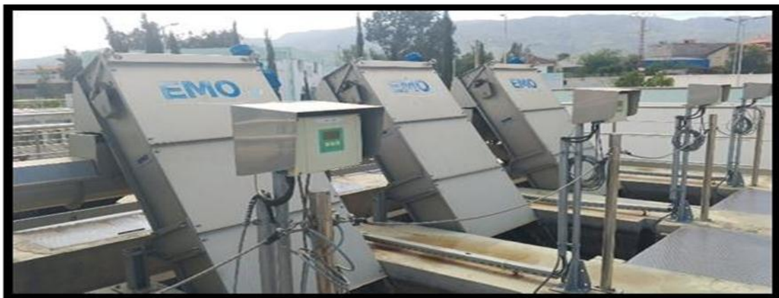
Figure N°30 : Dégrilleur automatique fin
